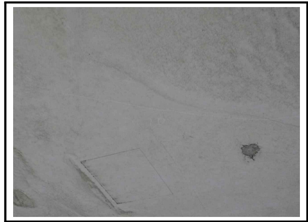
사진번호 20 천단부 S20 외관망도 4-2 균열(0.3mm 미만)
