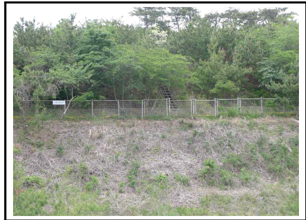
사진번호 80 사면 내 점검계단 및 헨스 설치현황 외관망도 -
