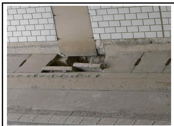
사진번호 58 공동구 S1 좌측 덮개 파손 외관망도 1-16
