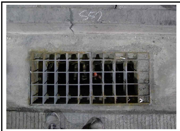
사진번호 55 집수구 S57 이물질 퇴적 외관망도 12-7
