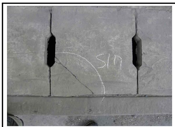
사진번호 60 공동구 S17 우측 덮개 파손 외관망도 4-5
