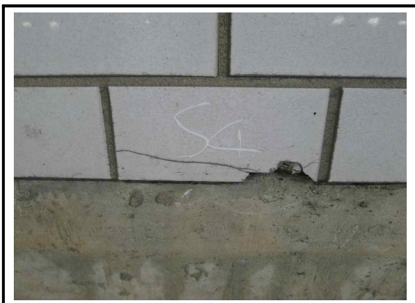
사진번호 33 측벽부 S4 우측 타일탈락, 파손 외관망도 1-24
