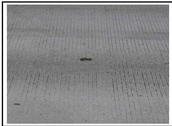
사진번호 68 포장부 S19 파손 외관망도 4-7
