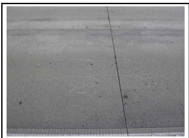
사진번호 71 포장부 S28 균열 외관망도 6
