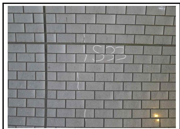
사진번호 36 측벽부 S33 좌측 타일 균열 외관망도 7-18
