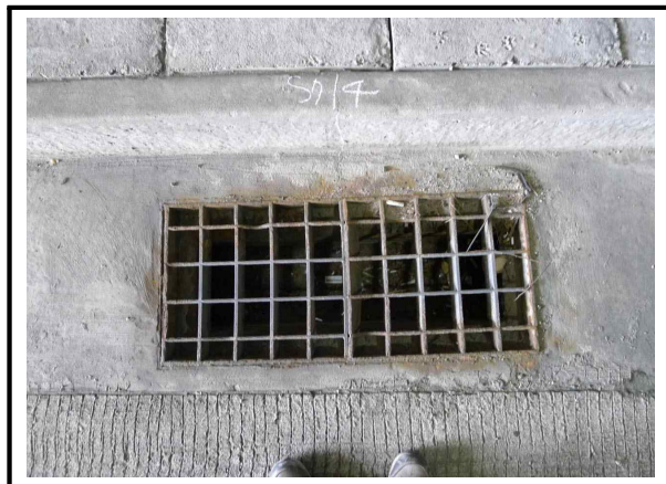
사진번호 56 집수구 S74 이물질 퇴적 외관망도 15-11
