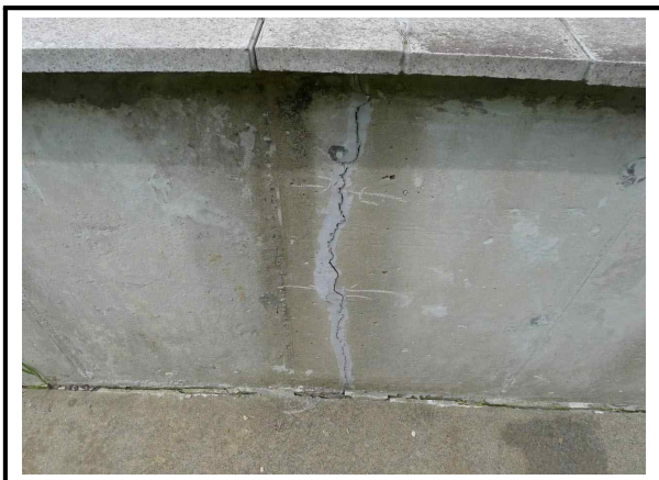
사진번호 83 시점 도수로 균열(0.3mm이 상) 외관망도 -
