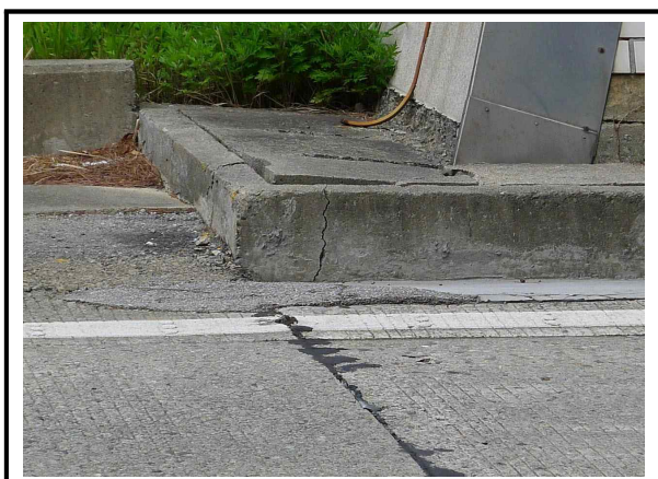
사진번호 57 공동구 S1 측면 균열(0.3mm 이상) 외관망도 1-25
