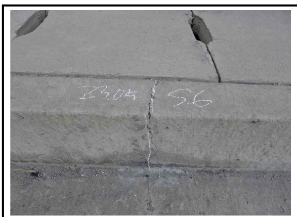
사진번호 59 공동구 S6 측면 균열(0.3mm 미만) 외관망도 2-9
