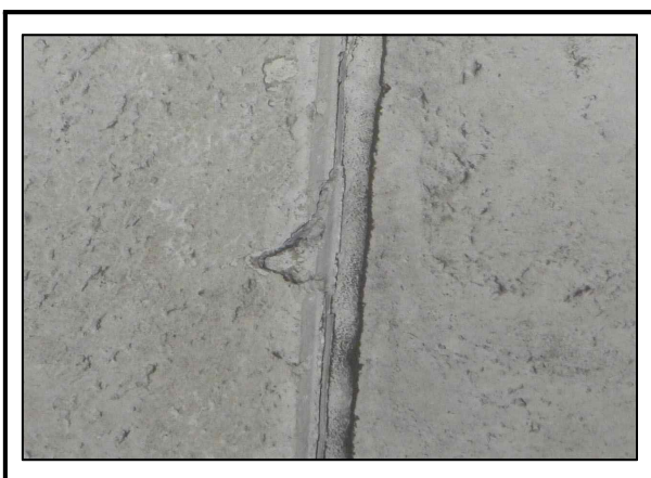
사진번호 23 천단부 S38(J38) 외관망도 8-10 시공이음부 박락
