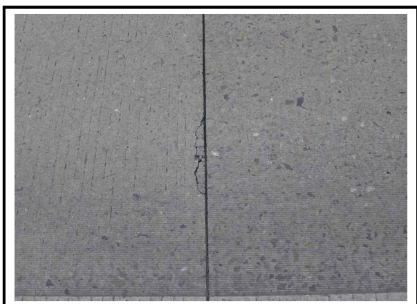
사진번호 69 포장부 S21 줄눈 주변 파손 외관망도 5
