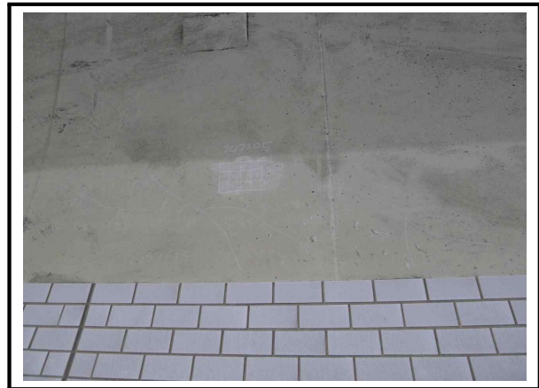
사진번호 32 측벽부 S4 우측 망상균열 외관망도 1-23
