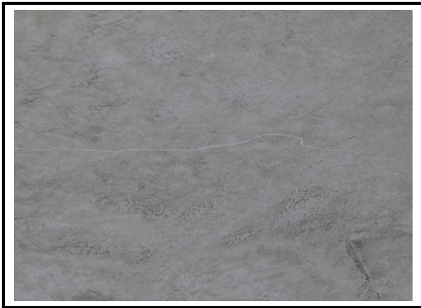
사진번호 19 천단부 S12 외관망도 3-11 균열(0.3mm 미만)
