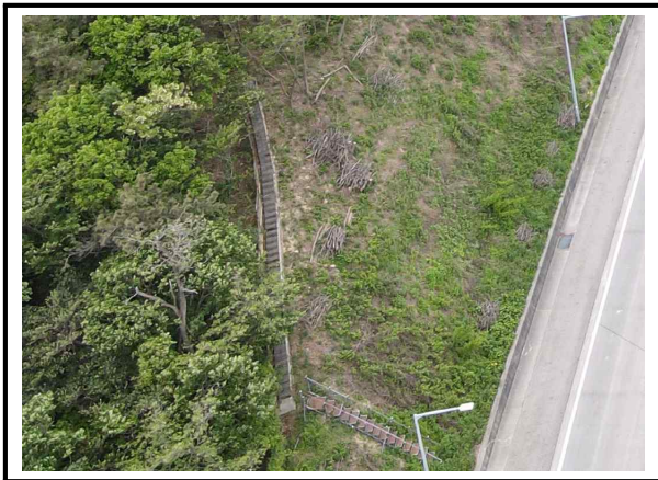
사진번호 91 사면 내 점검계단 설치현황, 경미한 부식 외관망도
