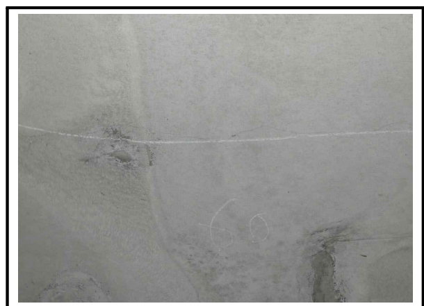
사진번호 24 천단부 S60 외관망도 12-2 균열(0.3mm 미만)
