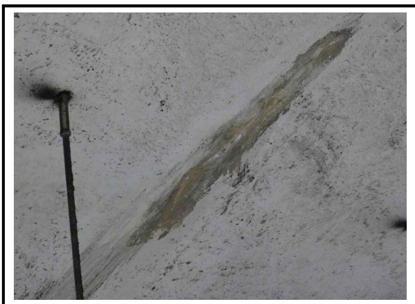
사진번호 21 천단부 S32 외관망도 7-22 균열부백태(0.3mm 미만)
